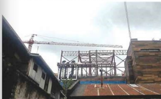
La DOM emitirá un informe sobre las obras de ampliación del recinto comercial.
